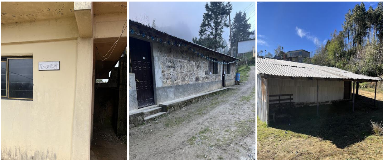
Imagen 5. Edificios destinados a Escoletas en mal estado
