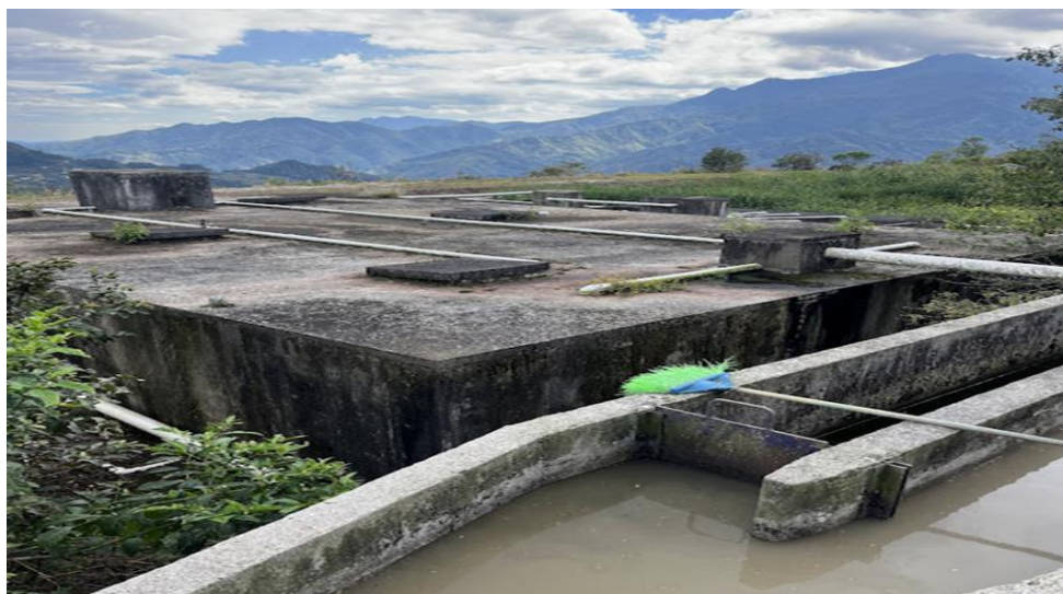
Imagen 18. Planta de tratamiento de aguas usadas
