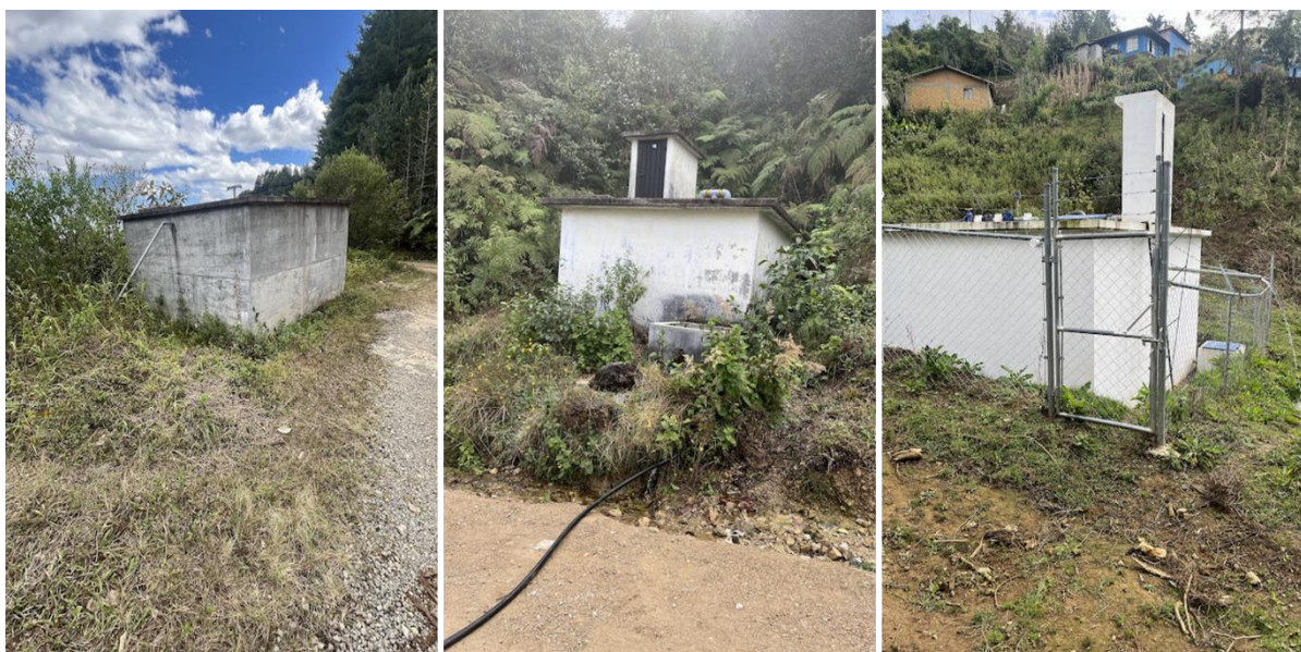
Imagen 17. Tanques de captación y pozo de los sistemas de agua
